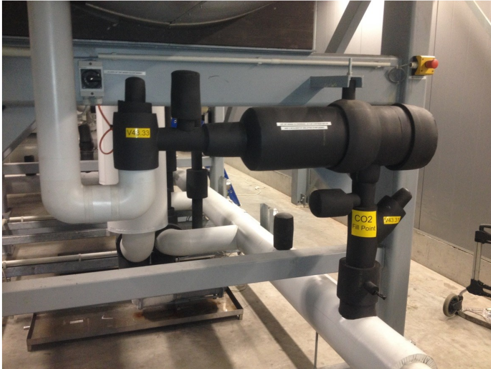
Afb. 4 Filter/drogers gemonteerd in een installatie
